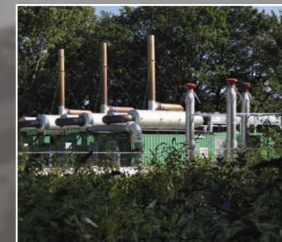
Grubengasabsauganlage, Zeche Unser Fritz
